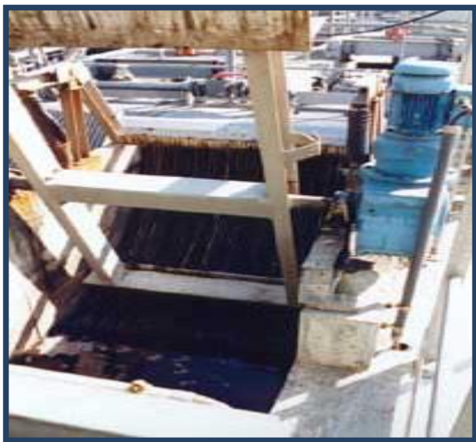
Dégrilleur à grille courbe
