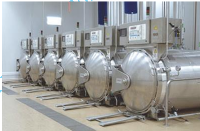
Batterie d'autoclaves industriels
