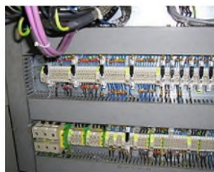
Connexions dans une armoire d'automate
